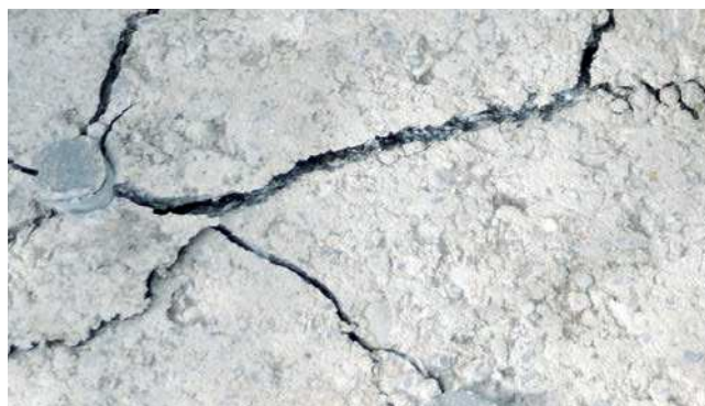
Spalten durch Quelldruck
